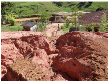
Figura 21 - Instabilidade do aterro
