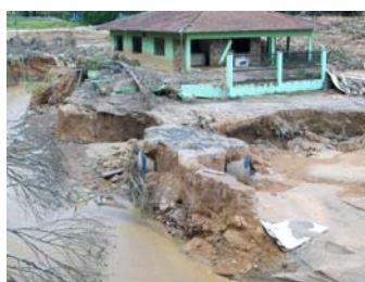
Figura 30 - Estradas e casas atingidas
