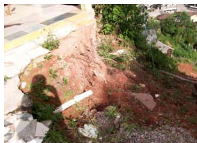
Figura 54 - Queda da residência
