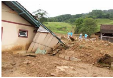
Figura 4 - Dano parcial na residência
