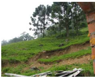
Figura 6 - Presença de degraus de abatimento
