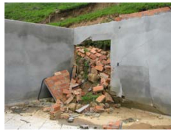
Figura 7 - Destruição total da residência
