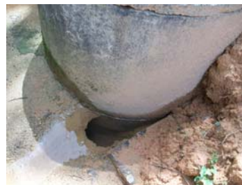
Figura 45 - Surgência de água
