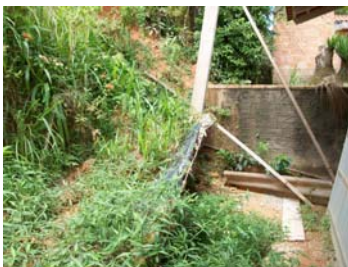
Figura 44 - Queda do muro
