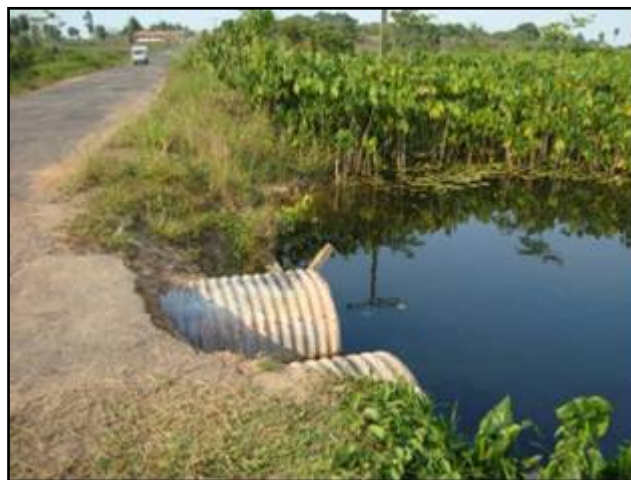
Figura 15: Igarapé da bacia do rio Peixe-Boi parcialmente barrado por tubulação sob via.
