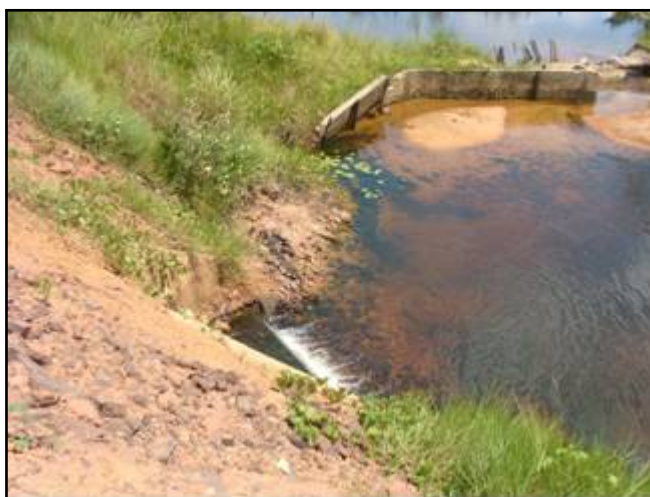
Figura 06: Talude desmoronando em virtude da erosão em afluente do rio Peixe-Boi.
