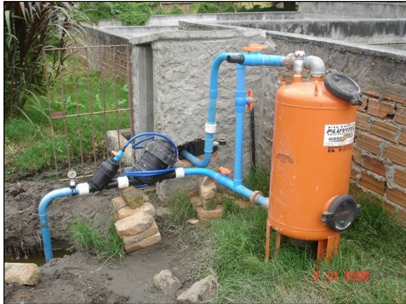
Figura 05 – Filtro de areia e filtros de disco de 2” e 4”
