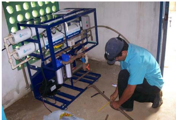
Figura 9 . Instalação do dessalinizador de osmose reversa na comunidade de Poço do Boi em Ibimirim – PE.
