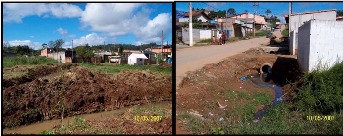
Figura 3: Lançamentos irregulares de esgoto in-natura (USSIER, 2006, 2007)
