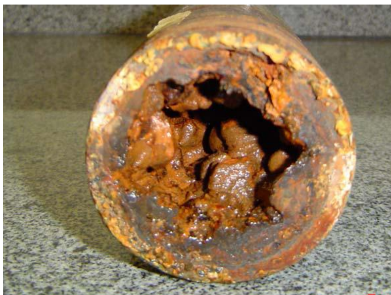
Figura 04 – Exemplo de Tubulação Incrustada (Fonte: Sabesp/2009)
