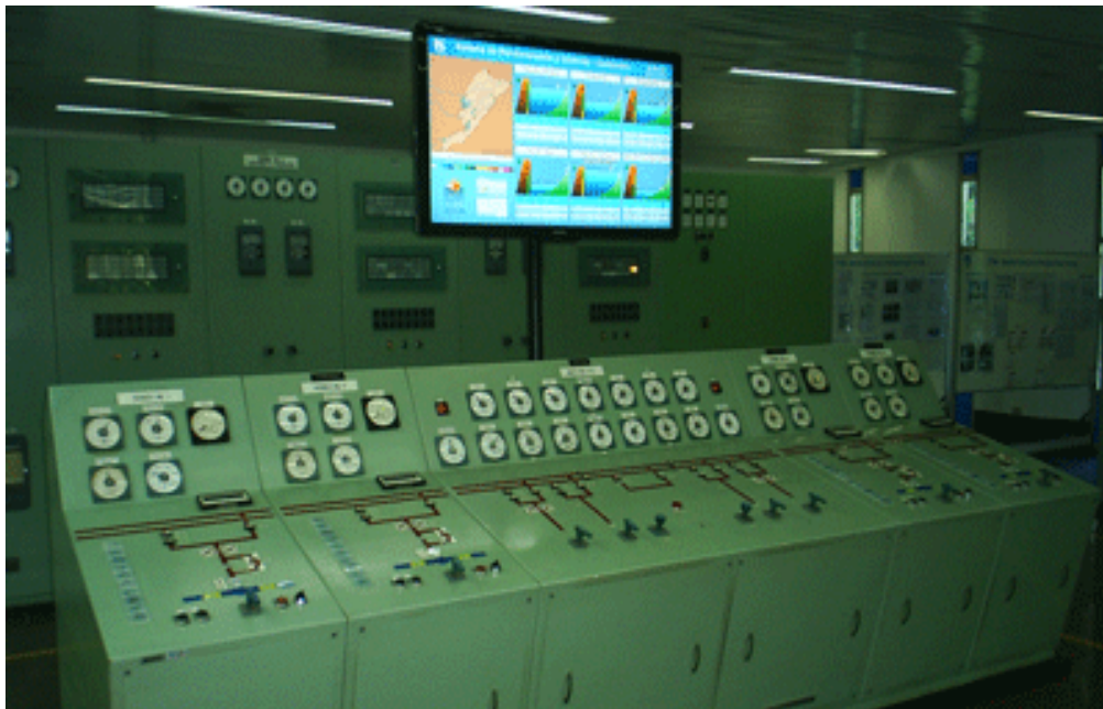
Figura 6 – Painel instalado na Sala de Comando e Controle da ESI
