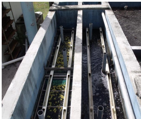
Figura 2. Biofiltros aerados preenchidos com eletroduto corrugado cortado e tubulações de PVC inseridas ao longo do leito filtrante.
