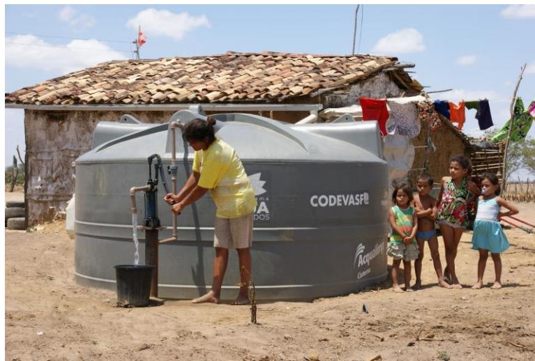
Figura 2 – Cisterna instalada na comunidade Serrote do Algodão – Craíbas/AL.
