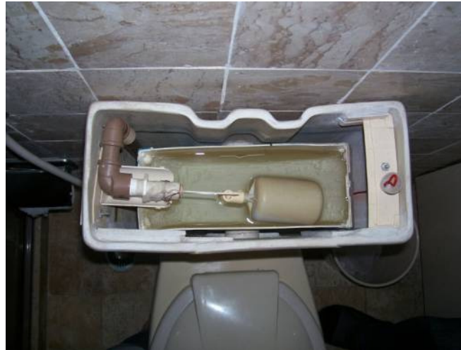
Figura 3 – Caixa instalada no banheiro suíte do casal
