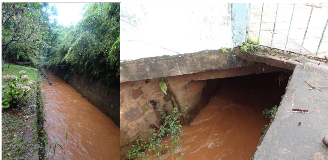
Figura 5 – canalização aberta na antiga captação, localizado no interior do terreno da SANEPAR.
