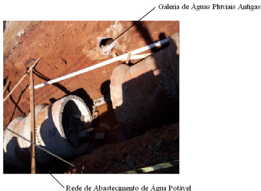
Figura 1 - Local onde será executado Poço de Visita e parte da Galeria de Águas Pluviais. Fonte: Autores, 2011.
