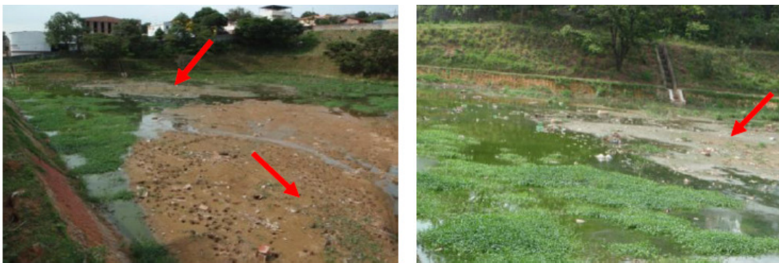
Figura 02 – Trecho de armazenamento da bacia Av. Liege: acúmulo de sedimentos e resíduos sólidos diversos. Vistoria realizada em 10/12/2012. Fotografias dos Autores
