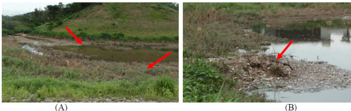
Figura 03 – (A) Área de inundação assoreada. (B) Gaiola de proteção parcialmente obstruída- Entrada da galeria de descarga de fundo. Vistoria realizada em 10/12/2012. Fotografias dos Autores
