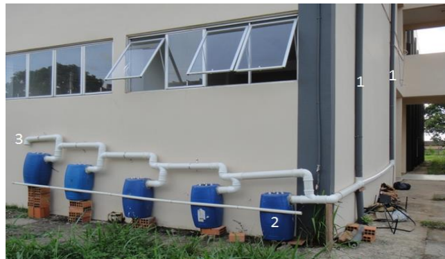
Figura 2 - Sistema de coletores instalados para armazenamento da água da chuva proveniente do telhado. (1) Canalização de transporte da precipitação do telhado para os coletores; (2) Coletores da precipitação; (3) Saída da água sobressalente.
