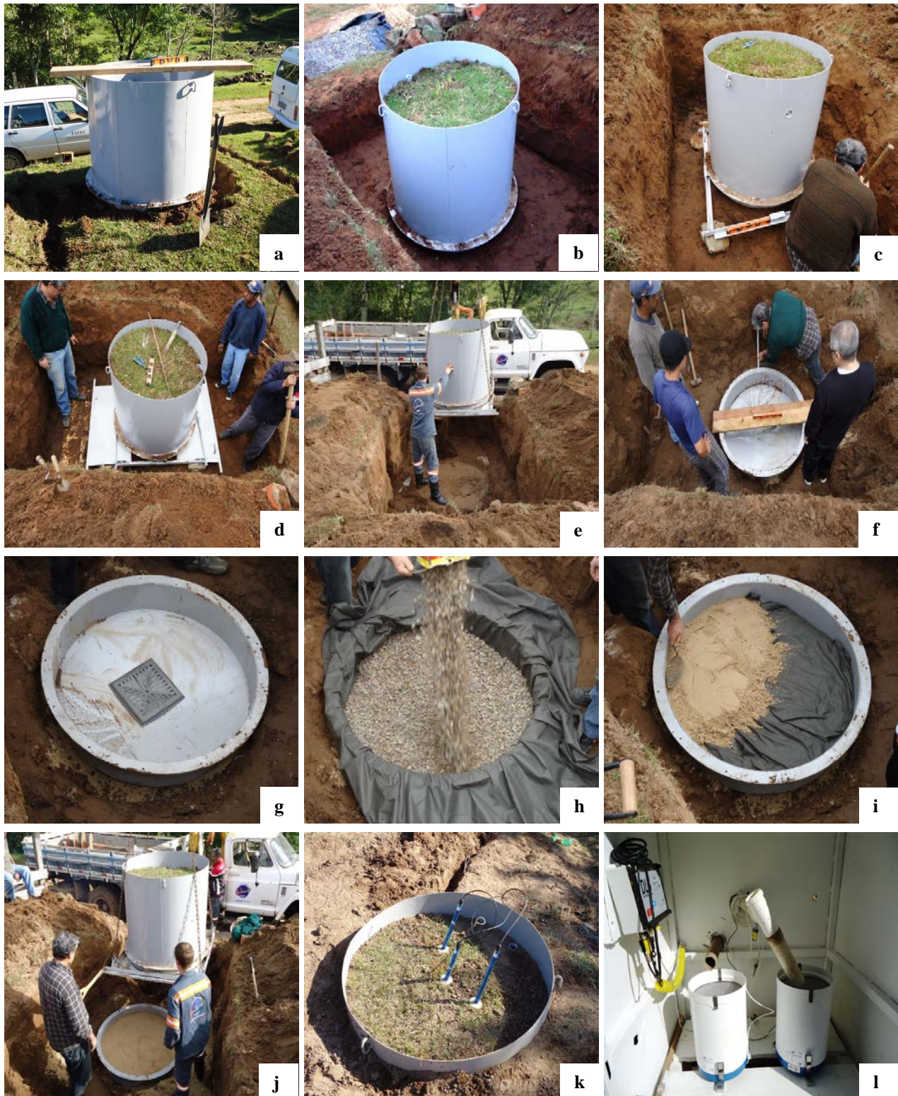
Figura 2 – Fazes de instalação do lisímetro de drenagem na área de campo nativo: a. escolha do local de instalação; b. abertura da trincheira; c. montagem da estrutura para elevação do lisímetro; d. introdução das lâminas e corte do solo; e. elevação do lisímetro com o auxílio de caminhão; f. instalação da base do lisímetro; g, h, i. confecção do sistema de drenagem; j. colocação do lisímetro sobre a sua base; k. lisímetro com tensiômetros eletrônicos já instalados; l. pluviômetros utilizados para monitoramento do escoamento superficial e drenagem resultantes.
