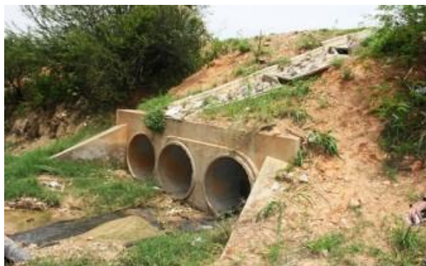
Figura 6 - Manilhas por onde passa grande parte do esgoto sem tratamento no Açude Itarandi – Conceição do Coité.
