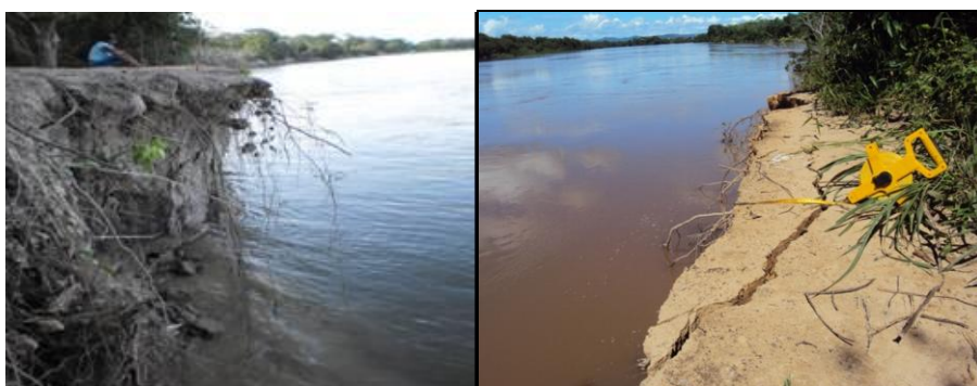
Figura 4. Processos erosivos com fendas nas margens em extensa faixa côncava do meandro (Ponto IV) FONTE: CRUZ et al. (2012) e Santos et al. (2012)
