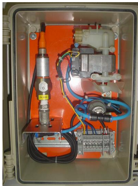
Figura 3: Quadro de instrumentação do sistema de medição de pressão utilizado.
