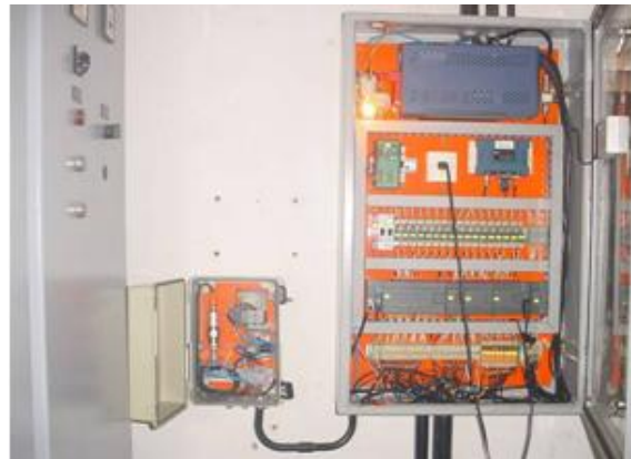
Figura 2: Sistema de medição de nível por borbulhamento controlado por um CLP.
