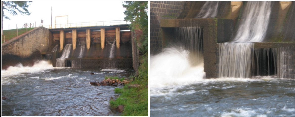
Figura 02 - Barragem Caunal. A esquerda visão global, madeiras fechando o vertedouro da represa, e conseqüente perda de água pelas frestas. A direita, destaque para a saída dos descarregadores de fundo.
