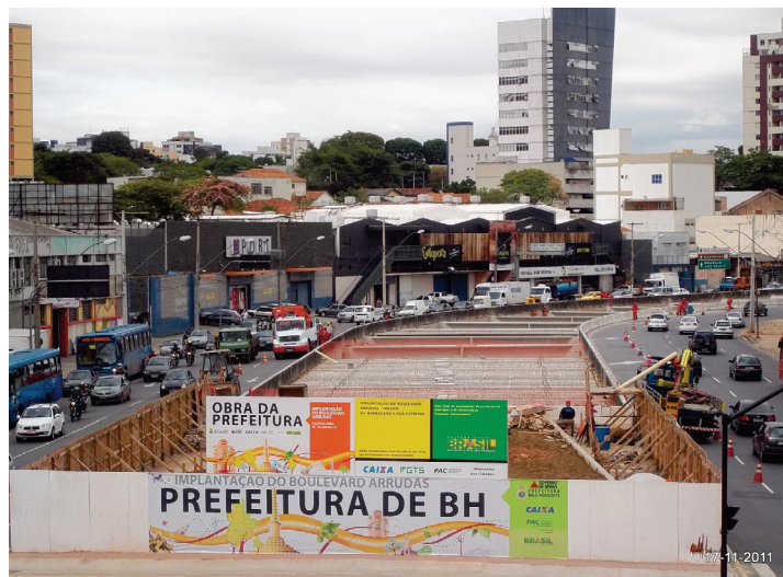
FIGURA 3: Obra de execução do Boulevard Arrudas (Trecho V). Fonte: Acervo da PBH.
