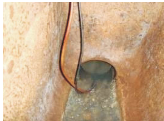
Figura 04 – Medidor de vazão instalado.
