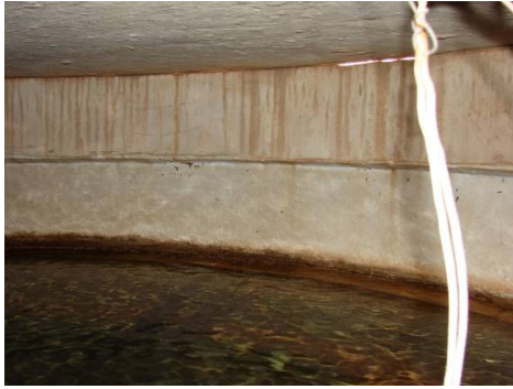
Figura 09 – Reservatório da Unidade VI sem impermeabilização
