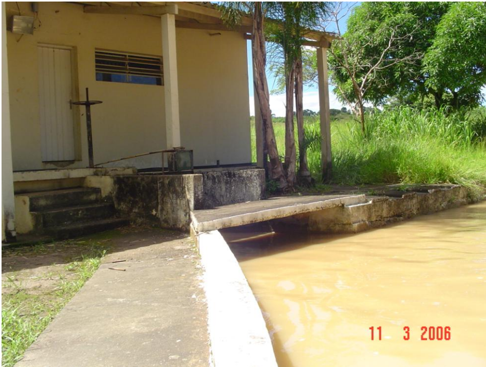
Figura 2 - Casa de bombas do sistema de abastecimento do DCTA inundada devido à ocorrência de forte chuva, em 11/03/2006.
