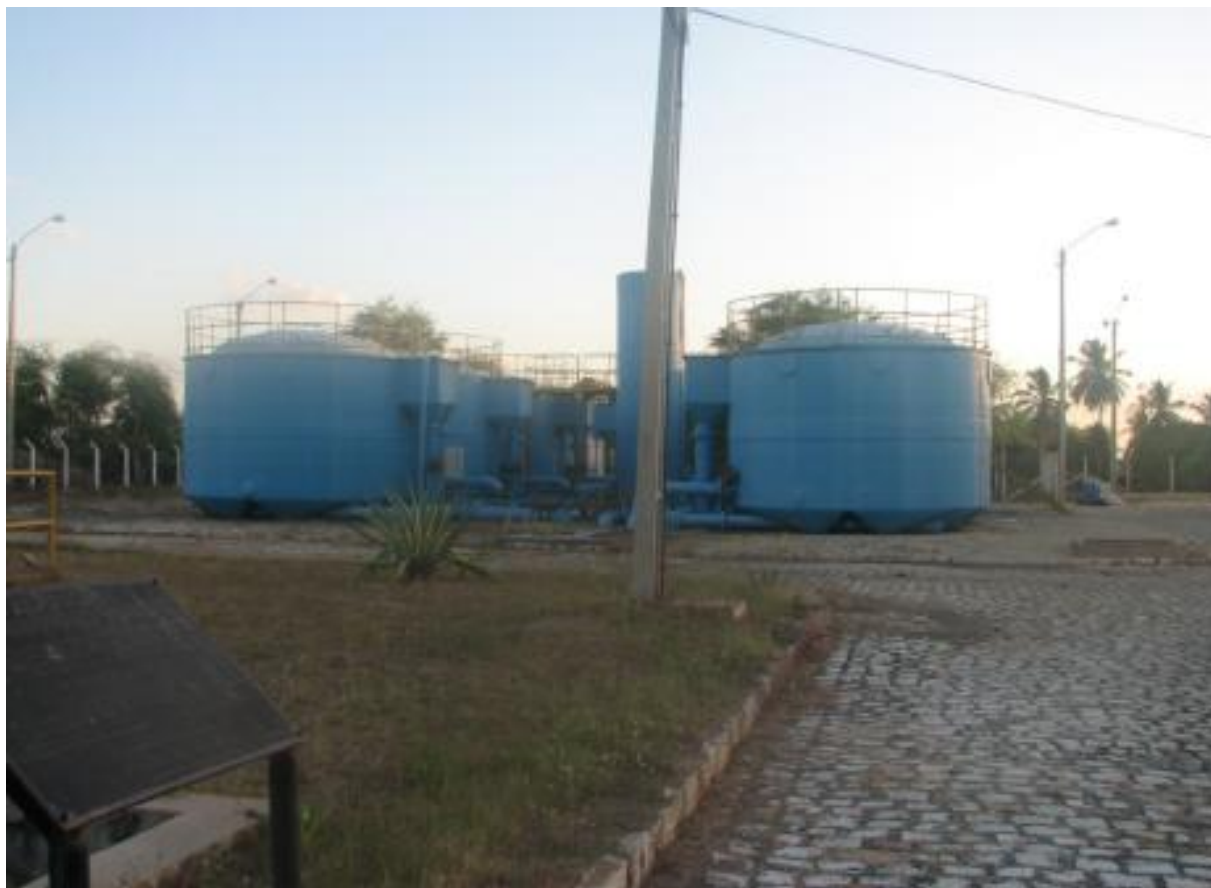
Figura 3 – ETA do Sistema Adutor de Mossoró. Tratamento por filtração direta ascendente. Assú RN
